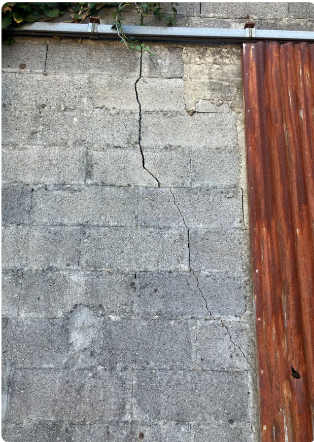
Exemple de fissure pouvant apparaître après une période de sécheresse.
